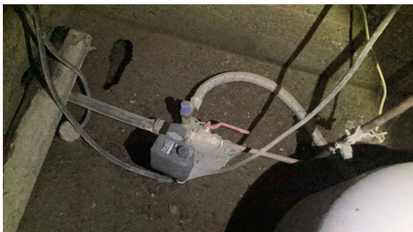
Stoppekran i kjeller.
