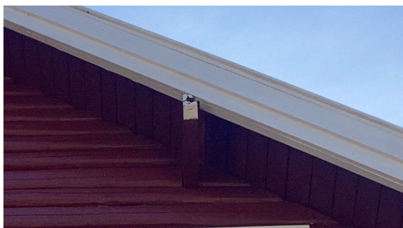
Råte i ende på sperre.
