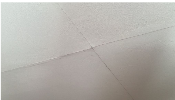
Eksempel på slitasje.
