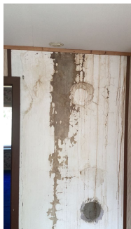
Eksempel på slitasje og rennemerker i 2. etasje.
