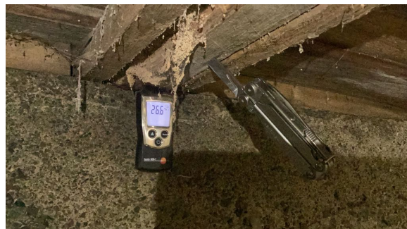
Eksempel på råteskade og høyt fuktinnhold.
