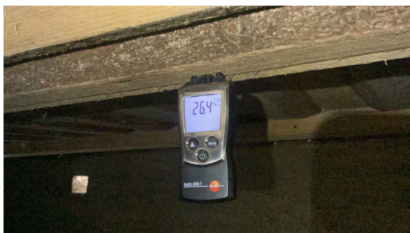
Målt fuktinnhold på ca. 26 vektprosent. Fuktinnhold i treverk på over 20 vektprosent medfører risiko for utvikling av sopp og råte.
