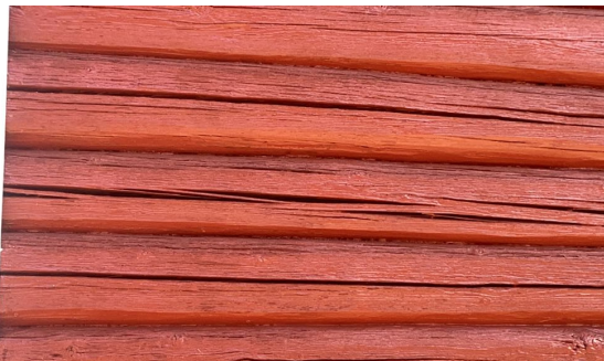
Eksempel på oppsprekking i tømmer.
