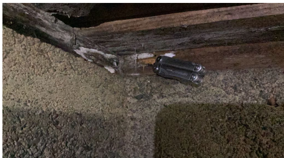
Eksempel på råteskade.
