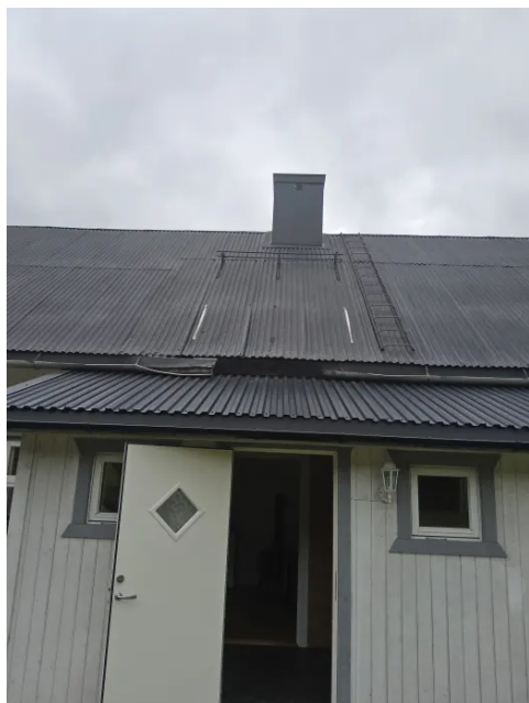
Bilde viser manglende snøfanger.
