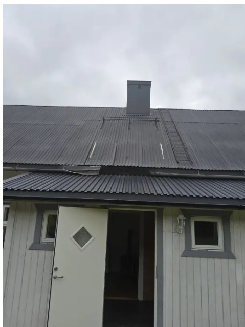
Bilde viser skadde takrenner.
