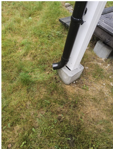
Bilde viser taknedløp avsluttet over bakken.
