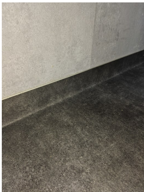
Bilde viser buling i baderomsplate.
