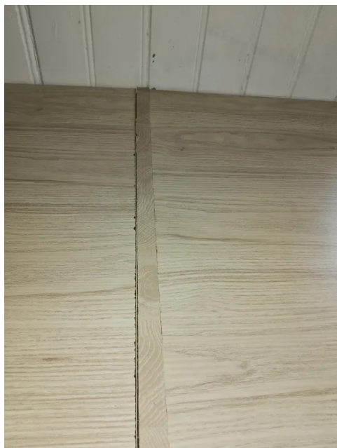
Bilde viser ufagmessig skjøting av benkeplate.
