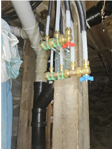
Bilde viser åpen rørfordeling.
