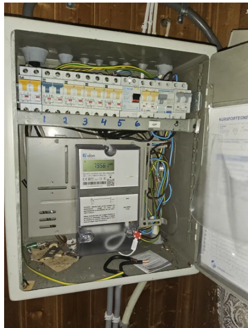
Bilde viser sikringsskap.
