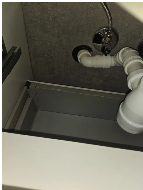
Bilde viser mangelfull tetting i rørgjennomføring under servant.
