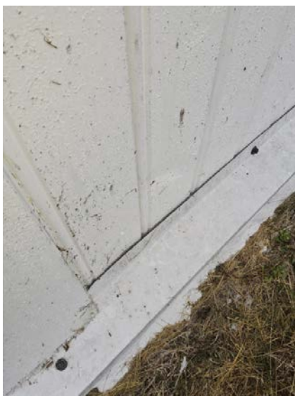
Bilde viser feilmontert vannbrettbeslag på nedre del av yttervegg.
