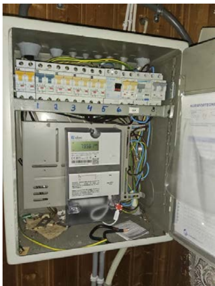
Bilde viser sikringsskap.
