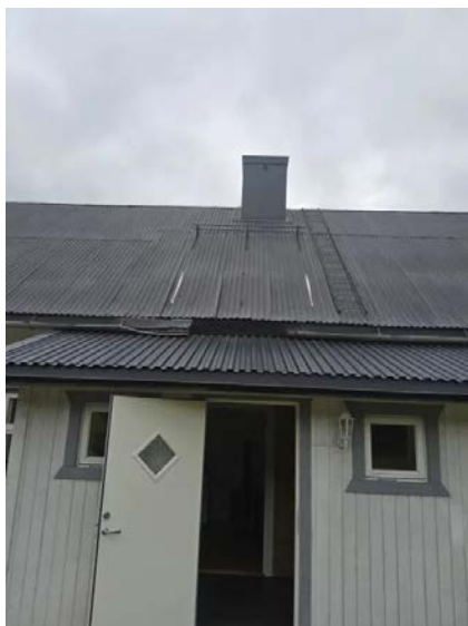
Bilde viser manglende snøfanger.
