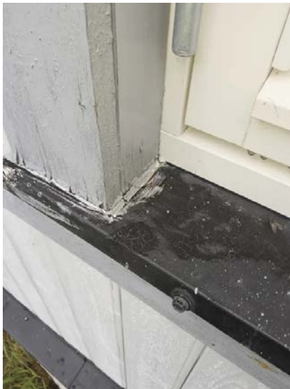
Bilde viser slitasje og omramming ført for nærme vannbrett.
