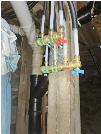
Bilde viser åpen rørfordeling.
