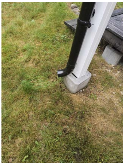
Bilde viser taknedløp avsluttet over bakken.
