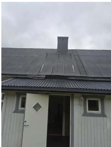
Bilde viser skadde takrenner.
