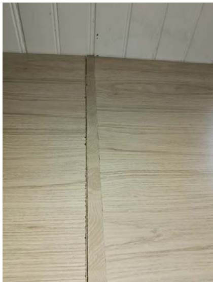
Bilde viser ufagmessig skjøting av benkeplate.
