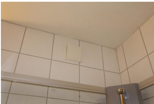
Ventil i kanal.
