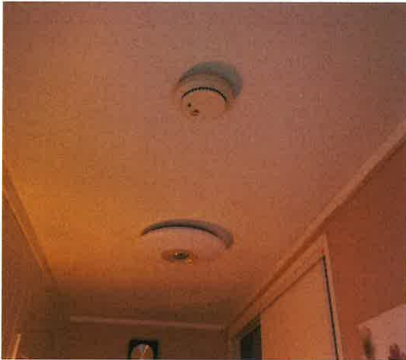
Bilde 1 Vf virker ikke.
