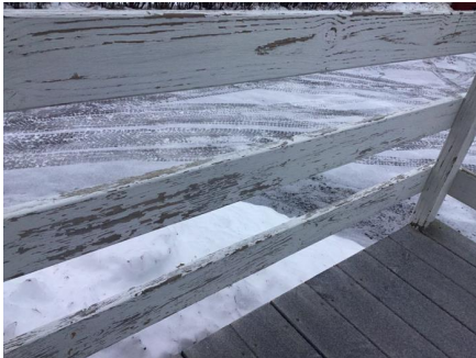
Eksempel på slitasje på rekkverk.
