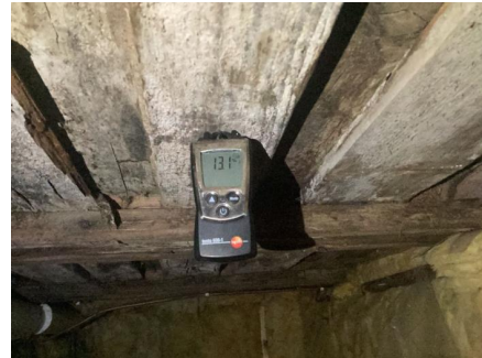
Fuktinnhold på under 20 vektprosent på kontrollert treverk i første kjellerrom.
