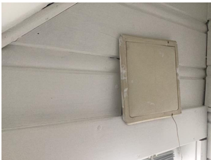
Uheldig plassering av veggventil.
