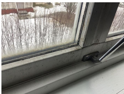
Eksempel på innvendig misfarging og slitasje.
