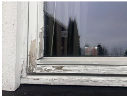
Eksempel på utvendig slitasje.
