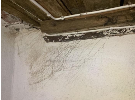
Det er stedvis synlig strengmycel i kjelleren.
