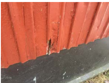
Råteskade på kjellerdør.
