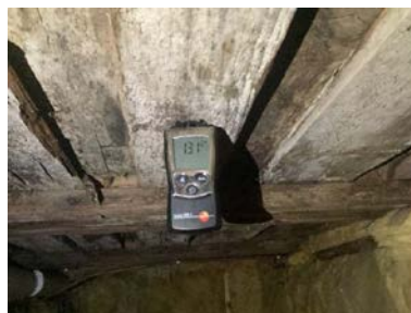
Fuktinnhold på under 20 vektprosent på kontrollert treverk i første kjellerrom.
