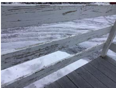
Eksempel på slitasje på rekkverk.
