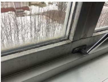
Eksempel på innvendig misfarging og slitasje.
