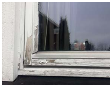
Eksempel på utvendig slitasje.
