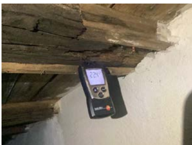
Flere steder høyt fuktinnhold i treverk og begynnende råteskader i innerste og midtre rom.
