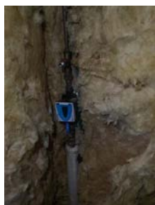
Vannmåler og stoppekran i kjeller.
