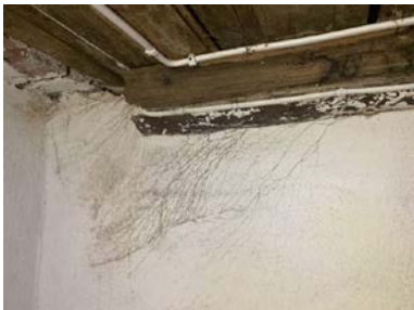
Det er stedvis synlig strengmycel i kjelleren.
