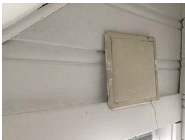
Uheldig plassering av veggventil.
