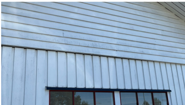
Vegg sunket litt- glipper fra gavlkledning
