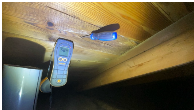
Lufteør belaster taktro som har noe begynnende råte
