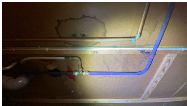
Rør kjeller- irr på koblinger
