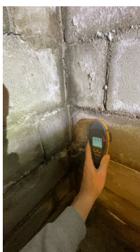
Skjolde hjørne vegg grovkjeller m/utslag fuktindikator
