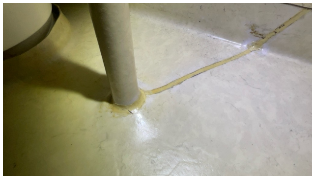
Marginal oppsprekk ved sveis til vannrør toalett
