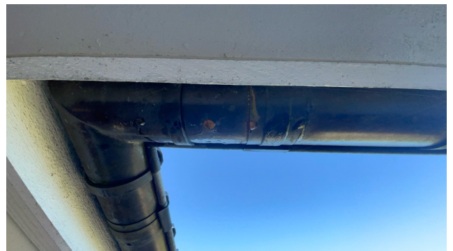
Eksempel punktlekkasje renne
