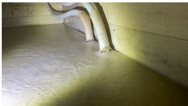
Oppsprekk sveiser til rør dusjkabinett
