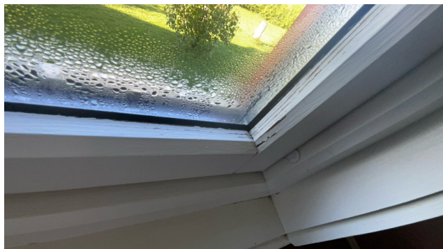
Kondensering i nedkant karm
