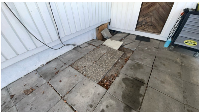
Hellegulv ujevnt og "vedinnkast" provisorisk tettet
