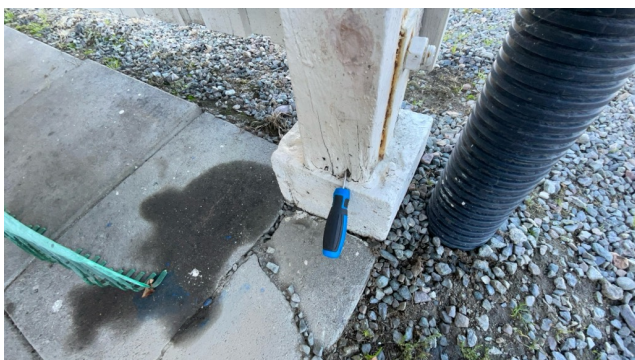
Litt råte i bunn tresøyle mot betongpilar
