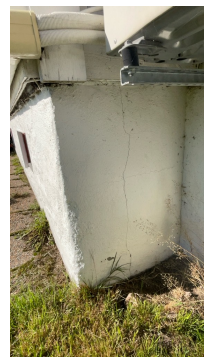
Eksempel sprekkdannelse mot hjørne
