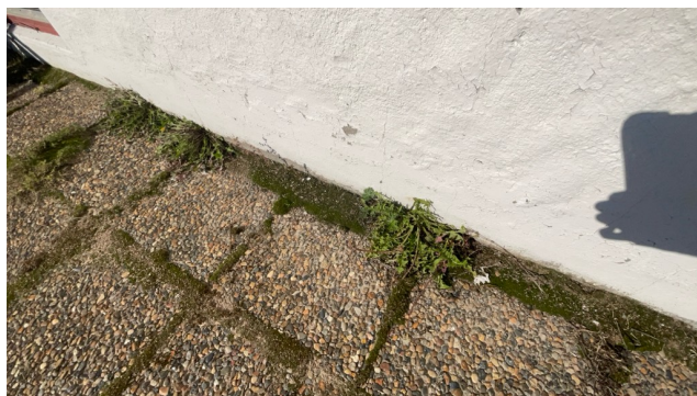
Ikke synlig fuktsperre på mur
