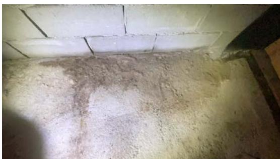
Skjold nedkant vegg grovkjeller
