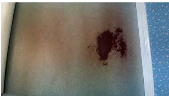
Stor missfarge/varmemerke belegg
