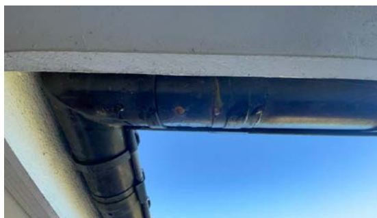
Eksempel punktlekkasje renne
