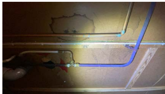
Rør kjeller- irr på koblinger
