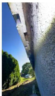
Ikke utlektet/luftet bak underliggere. Åpen isolering i nedkant/bunn mot mur på tilbygg.
