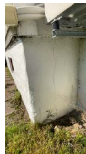
Eksempel sprekkdannelse mot hjørne
