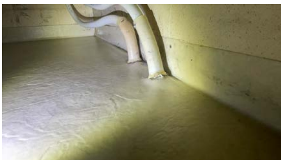
Oppsprekk sveiser til rør dusjkabinett
