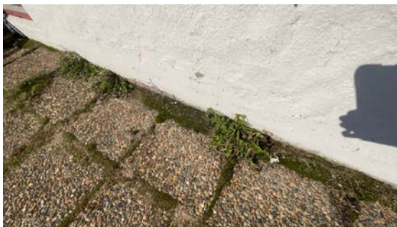
Ikke synlig fuktsperre på mur
