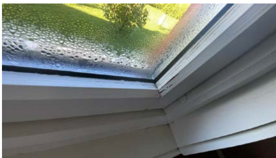
Kondensering i nedkant karm
