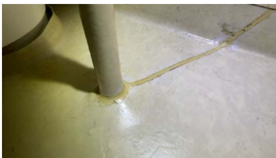
Marginal oppsprekk ved sveis til vannrør toalett
