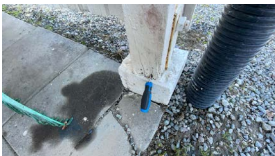
Litt råte i bunn tresøyle mot betongpilar
