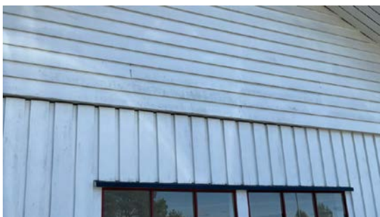
Vegg sunket litt- glipper fra gavlkledning
