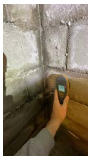
Skjold hjørne vegg grovkjeller m/utslag fuktindikator
