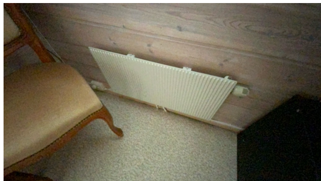
Radiatorer plassert rundt i boligen.
