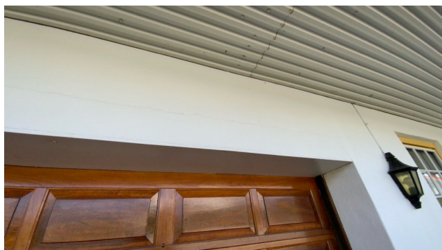
Stedvis riss i murpuss/grunnmur.
