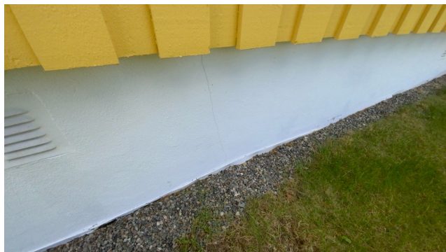
Stedvis riss i murpuss/grunnmur.
