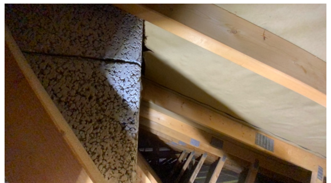
Utettheter rundt pipeløp.
