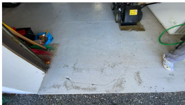
Synlig riss på betongsålen.
