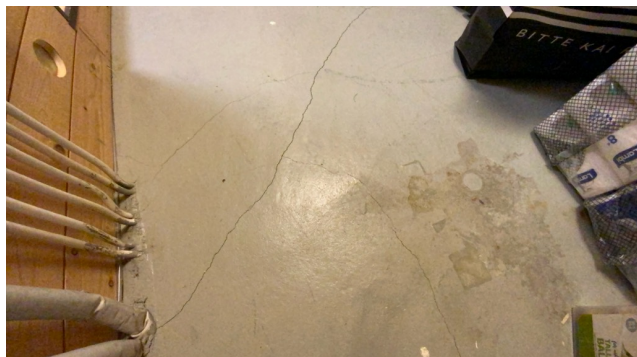
Synlig riss i sålen.
