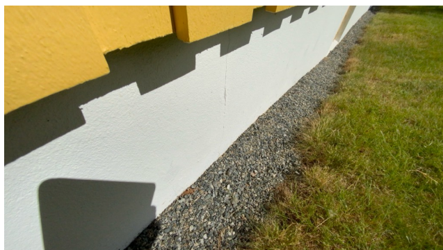
Stedvis riss i murpuss/grunnmur.
