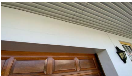
Stedvis riss i murpuss/grunnmur.
