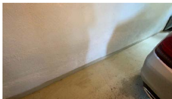
Synlig saltutslag på vegger.
