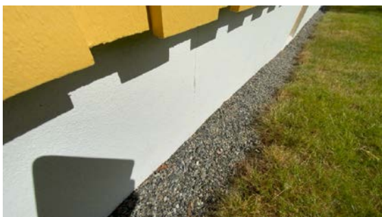
Stedvis riss i murpuss/grunnmur.
