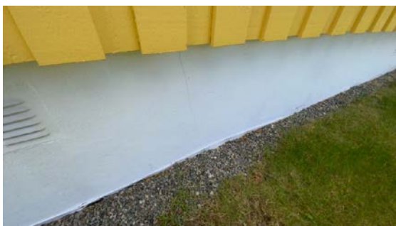
Stedvis riss i murpuss/grunnmur.
