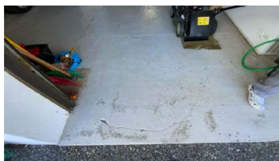
Synlig riss på betongsålen.
