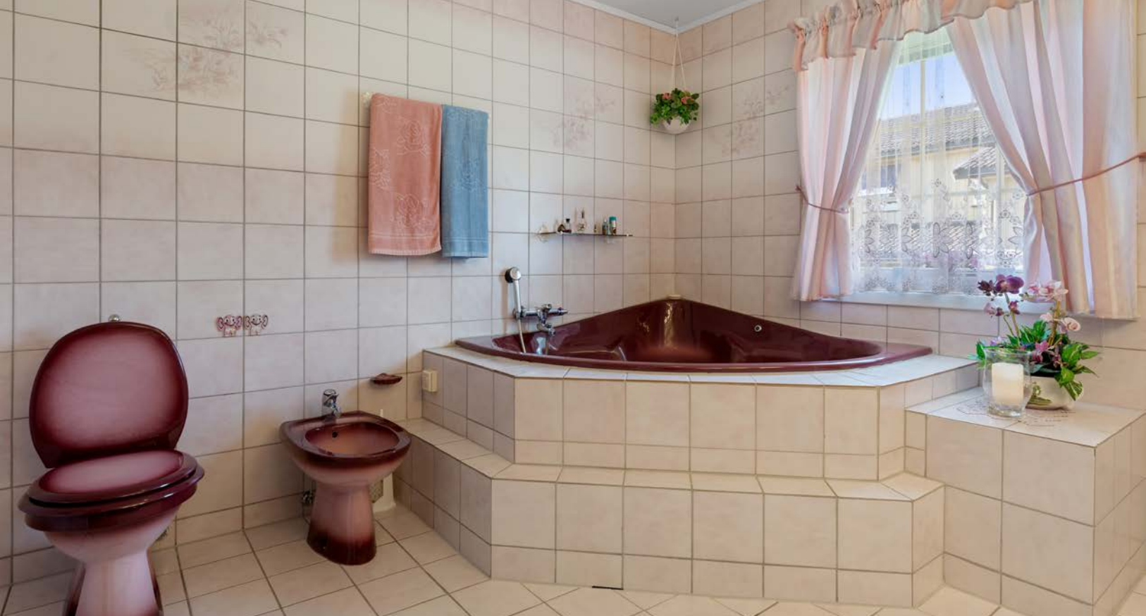
Flislagt baderom med innfliset hjørnekar, klosett, bidé og servant nedfelt i baderomsinnredning.
