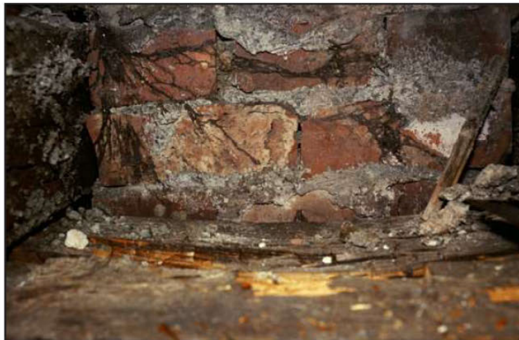
Mycelstrenger (sopptråder) av kjellersopp på teglstein. Kjellersopp har relativt liten evne til å spres ved hjelp av mycelstrengene.
