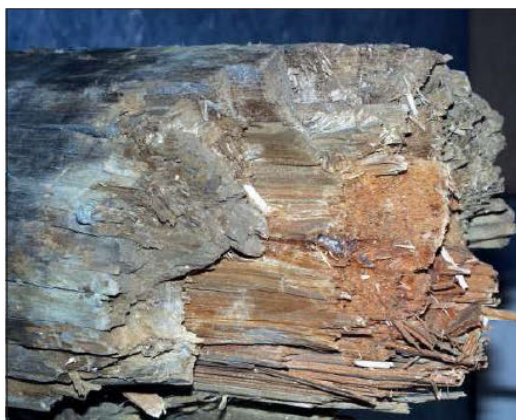
Kraftige gråråteskader i telefonstolpe.
