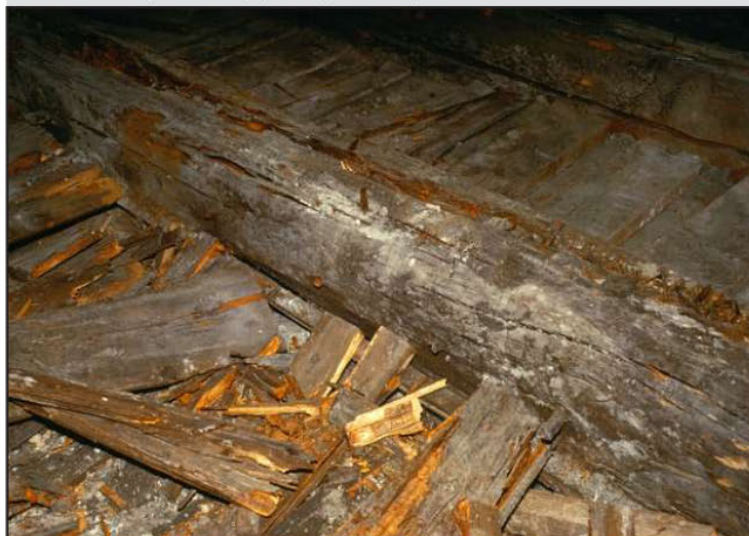
Tremateriale nedbrutt av kjellersopp. Overflaten av trematerialet kan ofte virke lite skadet selv om kjernen er helt ødelagt.
