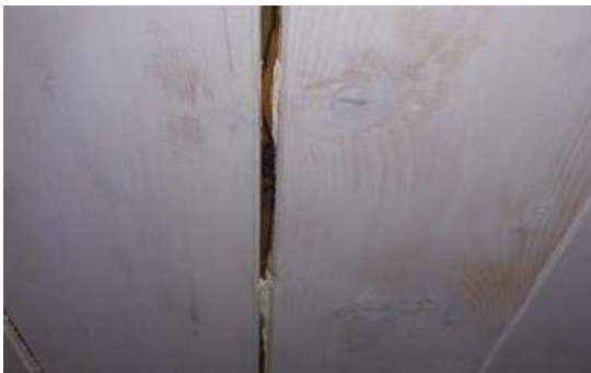
Synlig rotteavføring i glipe i taket.
