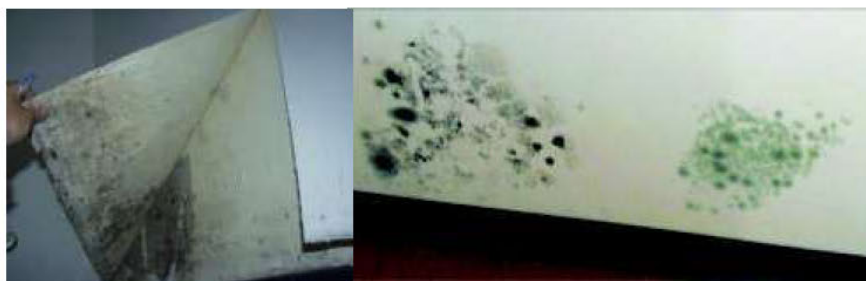
Vekst av muggsopp på gipsplate
