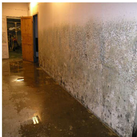
Muggsoppvekst som følge av vannskade.
