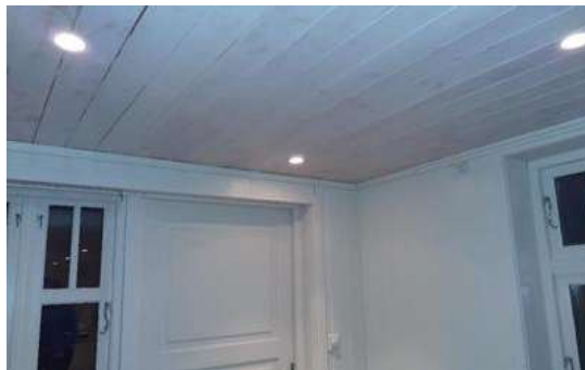
Forsikringstaker har funnet rotteavføring som faller ned fra taket.
