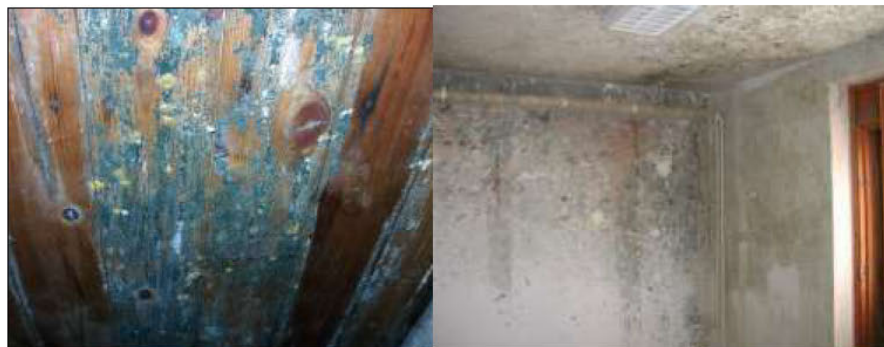
Muggvekst etter vannlekkasje.
