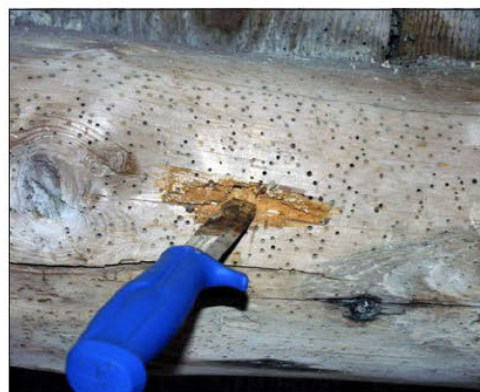
Stripet borebiller finnes ofte i fuktige kjellere. Larvene lever av friskt (ikke råtesoppeskadet) treverk.
