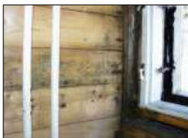
Muggsoppskader som følge av oppfuktning etter brannsløkking.
