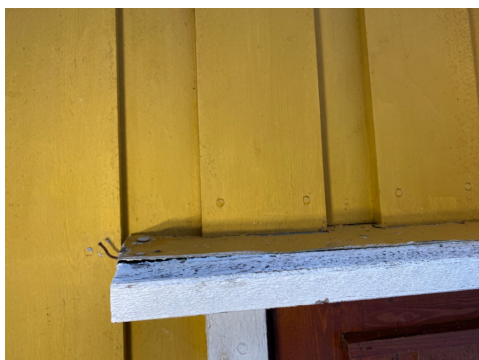
Dører mangler delvis beslag over vannbrett. Utvendige kledning er satt helt ned på beslag, skadeutsatt løsning med fuktopptrekk og påfølgende råteskader.
