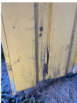
Bordkledning er stedvis værøpsprukket/råteskadet.
