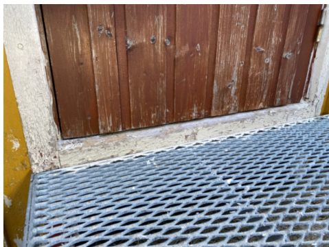
Omramming har råteskader beslag mangler.
