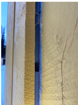
Asbestplater på bakside av kledningen.
