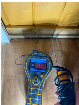
Det er målt høyt fuktinnhold mot vaskelist.
