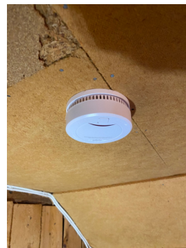
Røykvarsler i stuen og i loftsetasjen.
