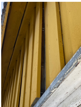
Kledningen er stedvis løsnet grunnet dårlig innfestning.
