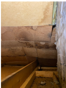
Fuktskader. Det ble registret spor av mus på kaldloftet.
