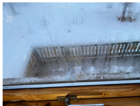
Vindu med punktert glass og råteskader. Vindu mot nordvest lar seg ikke åpne.
