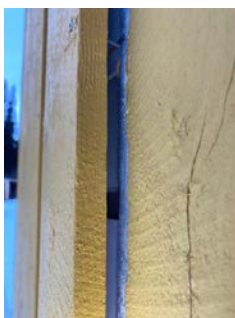
Asbestplater på bakside av kledningen.
