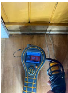
Det er målt høyt fuktinnhold mot vaskelist.
