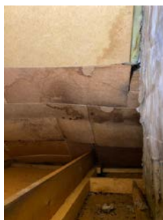
Fuktskader. Det ble registrert spor av mus på kaldloftet.
