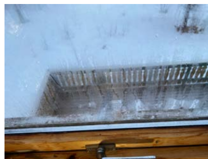
Vindu med punktert glass og råteskader. Vindu mot nordvest lar seg ikke åpne.
