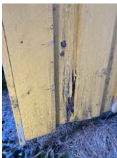
Bordkledning er stedvis værøppsprukket/råteskadet.
