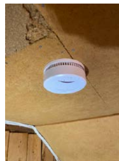
Røykvarsler i stuen og i loftsetasjen.
