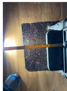
Brennbar plate under vedovner er for liten.
