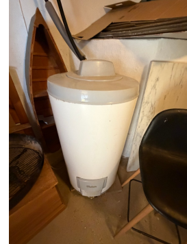
Varmtvannstank i kjeller datert 2010
