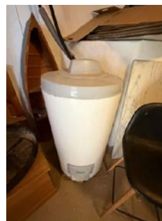
Varmtvannstank i kjeller datert 2010
