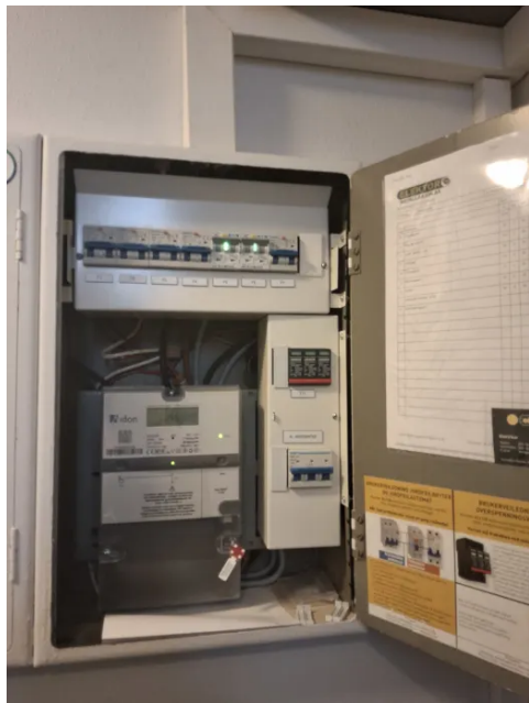
Sikringsskap er plassert i felles trappegang.
