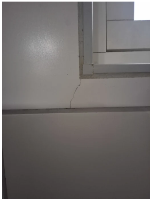
Sprekk i veggflis.
