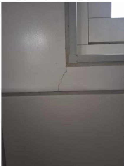
Sprekk i veggflis.
