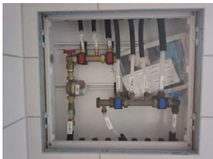
Fordelerskap for rør-i-rør er plassert på.
