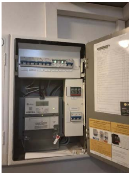
Sikringsskap er plassert i felles trappegang.
