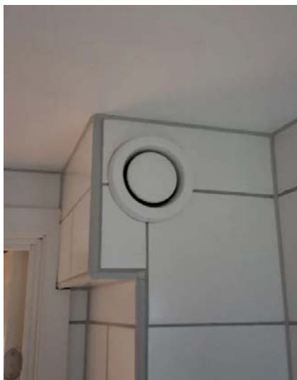
Det er ikke etablert mekanisk avtrekksventilasjon på badet.
