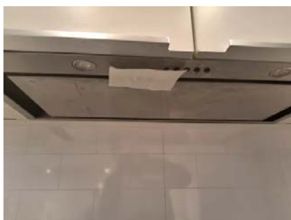
Avtrekkseffekt er testet med papir.
