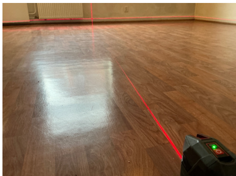
Nivellering stu, avvik ca. 15-30 mm
