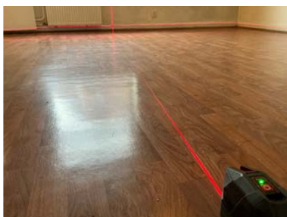
Nivellering stu, avvik ca. 15-30 mm
