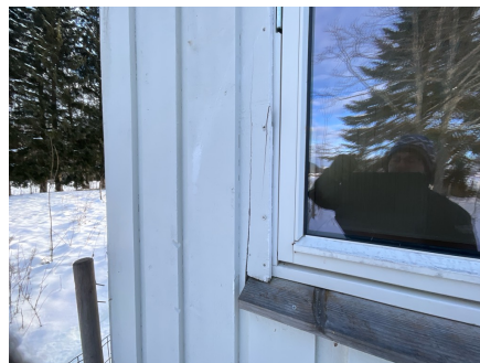
Sprekk i kledning rundt enkelte vinduer
