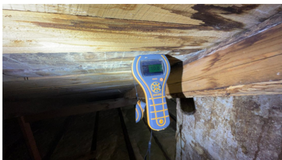
Utført fuktmåling ved pipe
