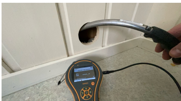
Fuktmåling inne i vegg, fuktmerke inne i vegg var ikke lett å vise på bilde
