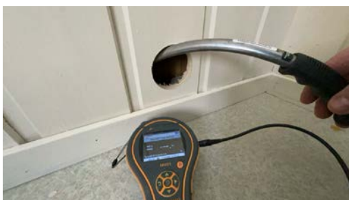
Fuktmåling inne i vegg, fuktmerke inne i vegg var ikke lett å vise på bilde
