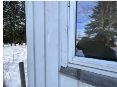
Sprekk i kledning rundt enkelte vinduer
