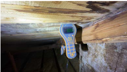
Utført fuktmåling ved pipe
