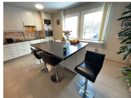
1. etasje Plassering av laser på vedovn ved kontroll av kjøkken. Det er målt 8 mm høydeforskjell gjennom rommet. TG 1
