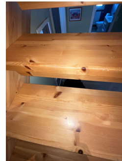
Det er noe skader og merker i trappa ut fra bruk.
