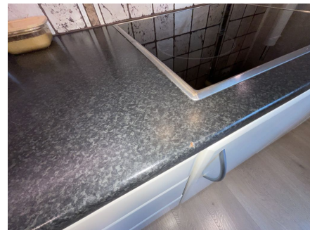
Kantskade på benkeplate ved kokesone er utbedret etter befaringen.
