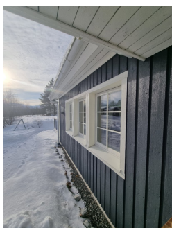
Synlige luftespalter i raftekasse
