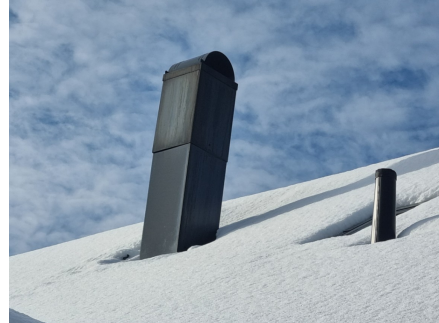
Noe sot avrenning på pipehatt.
