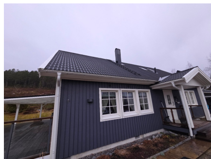
Bilde tatt ved ny befaring 19.03.2025
