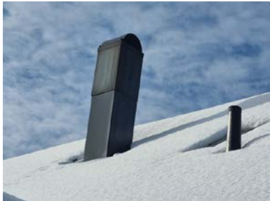
Noe sot avrenning på pipehatt.
