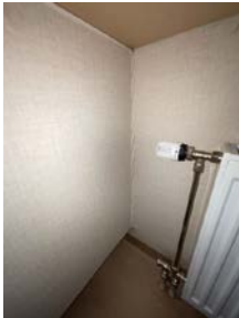
Løs tapet i hjørne mellom vegg og skap
