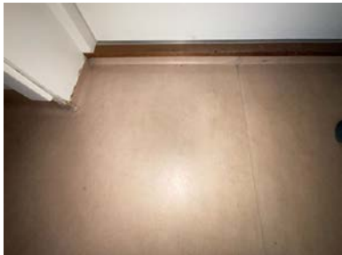
Noe slitasjemerker i overflate på gulvbelegget ved dør ut mot garasje
