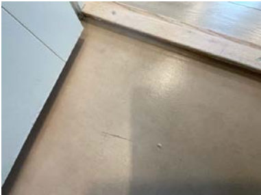
Liten slagskade i gulvet like ved dør mot kjøkkenet
