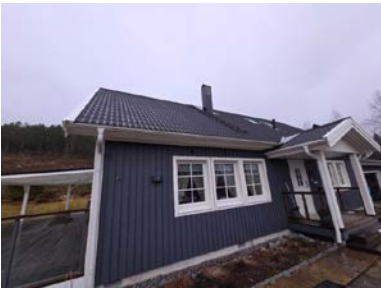
Bilde tatt ved ny befaring 19.03.2025
