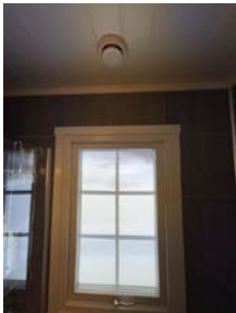
Mekanisk avtrekk i himling og åpningsvindu
