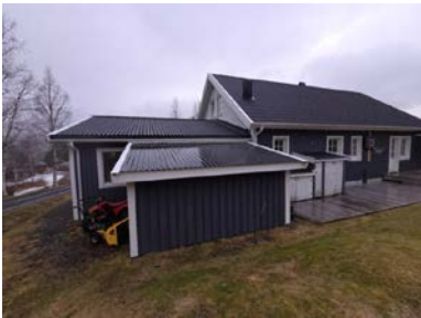
Bilde tatt ved ny befaring 19.03.2025
