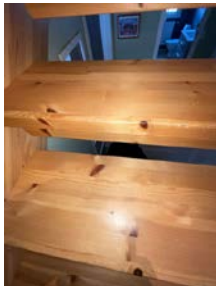
Det er noe skader og merker i trappa ut fra bruk.
