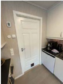
Dør til vaskerom sett fra kjøkken hvor det er montert katteluke
