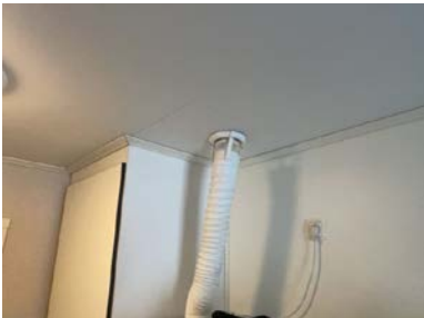
Mekanisk avtrekk i himling
