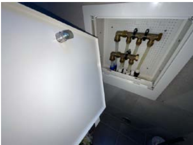
Vannfordeling bad oppe på loftet
