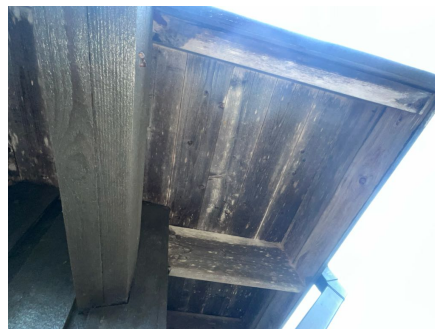
Stedvis fuktmerker og svertesopp under gesi
