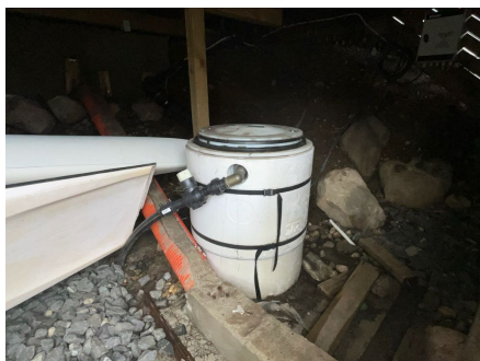
Utsnitt tank og kontrollpanel.
