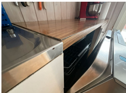
Svelling i benkeplate.
