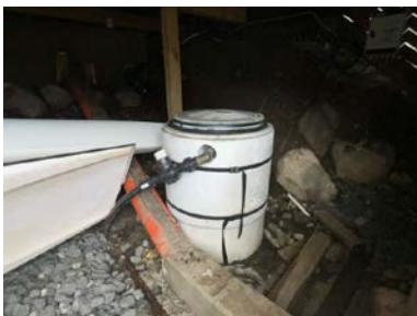
Utsnitt tank og kontrollpanel.
