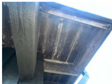
Stedvis fuktmerker og svertesopp under gesi
