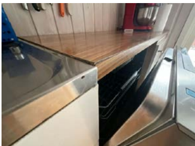
Svelling i benkeplate.
