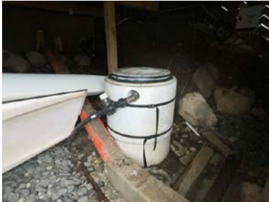
Utsnitt tank og kontrollpanel.
