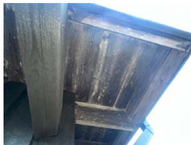
Stedvis fuktmerker og svertesopp under gesi
