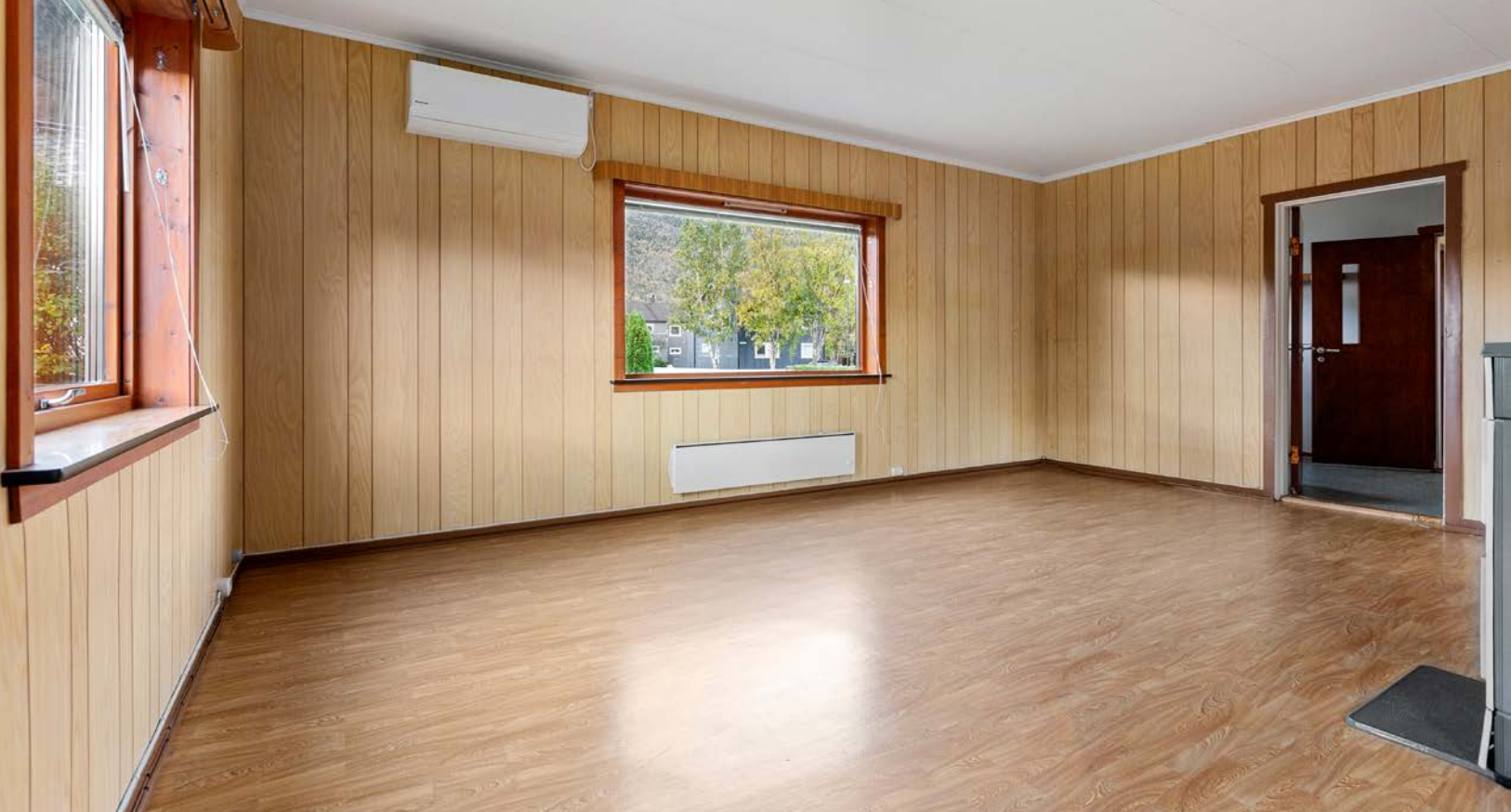
Varmepumpen er montert i 2022
