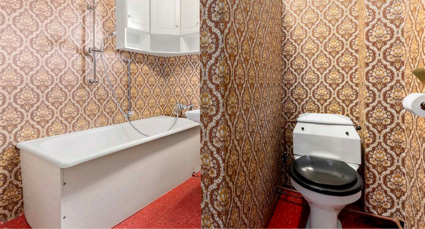
Bad i hovedetasjen fra byggeår står foran renovering for å tåle dagens bruk.
