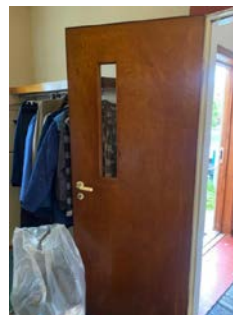
Dør mellom gang og yttergangen bør justeres.
