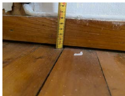
Glippe mellom gulv og list på stuen i 2. etg.
