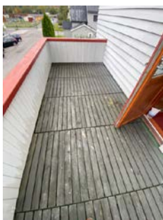
Værslitt, delvis råteskadd tredekke.
