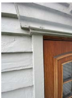
Kledning er ført helt ned mot beslag.
