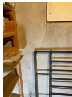
Skråriss i kjellermur på vaskerommet.
