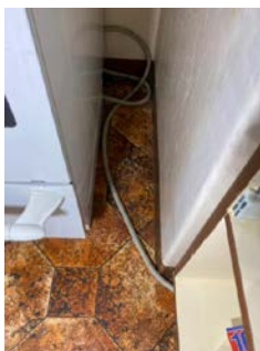
Kabel fra komfyr går inn under gulvsokkel.
