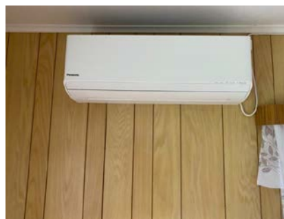
Varmepumpe stue 1 etg.
