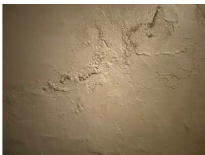
Saltutslag på vegger.
