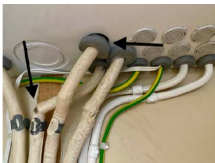
Tegn på varmgang på ledning, uttett kabelgjennomføring.
