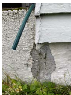
Sprekkdannelser i mur mot vest.
