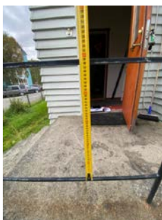
Vertikal åpning i rekkverk ved hovedinngang.
