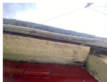
Ingen lufting bak kledning.
