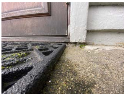
Dør bør heves/beslag bør etableres.
