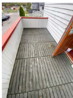
Værslitt, delvis råteskadd tredekke.
