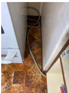
Kabel fra komfyr går inn under gulvsokkel.
