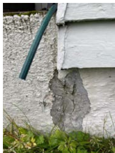
Sprekkdannelser i mur mot vest.
