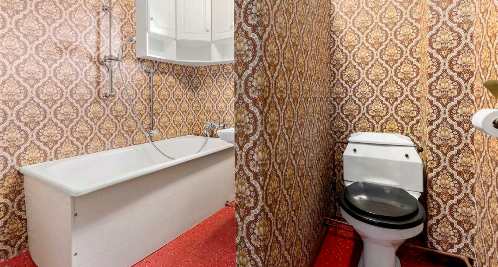
Bad i hovedetasjen fra byggeår står foran renovering for å tåle dagens bruk.
