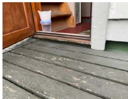
Manglende beslag under døren.
