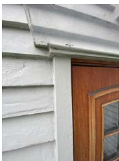
Kledning er ført helt ned mot beslag.
