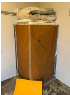
Varmtvannstanken er kledd med isopor og duk.
