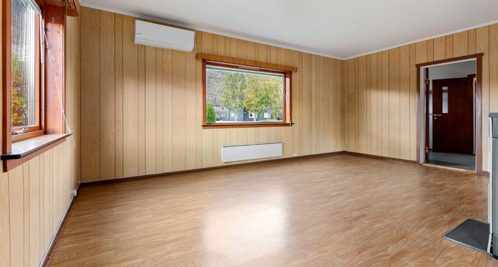
Varmepumpen er montert i 2022
