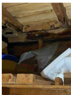
Fuktskader i treverk under tekkingen til balkongen.
