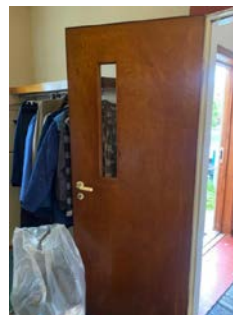
Dør mellom gang og yttergangen bør justeres.
