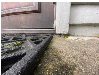
Dør bør heves/beslag bør etableres.
