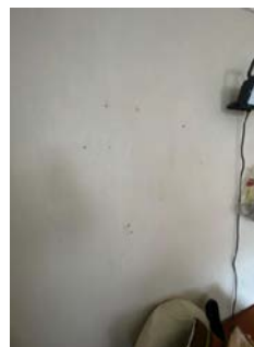
Vegger har en del skader i overflaten, stue 2 etg.
