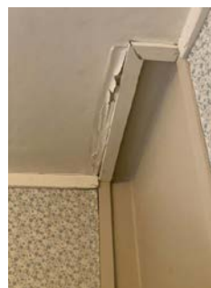
Avflasket maling i tak på soverom i 2 etg.
