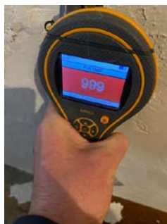
Fuktmåling mot yttervegg, gangen.
