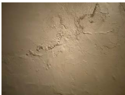
Saltutslag på vegger.
