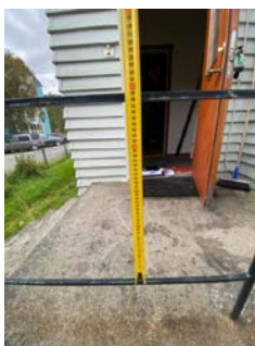
Vertikal åpning i rekkverk ved hovedinngang.
