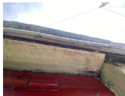
Ingen lufting bak kledning.
