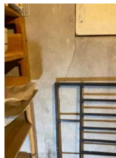
Skråriss i kjellermur på vaskerommet.
