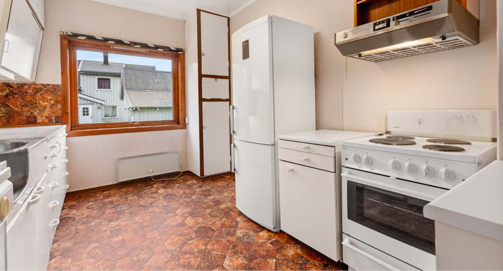
Oppvaskmaskin, komfyr og kjøleskap Kjøkkenventilator ført ut gjennom kanal i pipeløp.
