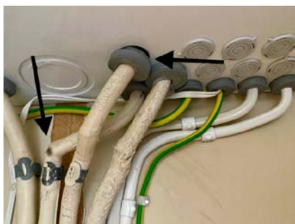
Tegn på varmgang på ledning, uttett kabelgjennomføring.
