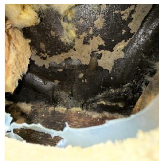
Synlig våt grunnmur og svill ved hulltaking
