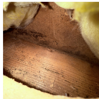
Synlig muggsopp ved hulltaking
