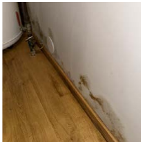
Fuktmerker på vegg og gulvlist i bod
