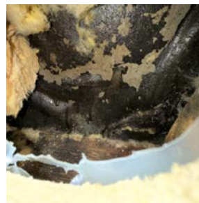
Synlig våt grunnmur og svill ved hulltaking
