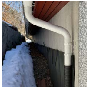
Terrang ved yttervegg mot nord
