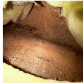
Synlig muggsopp ved hulltaking
