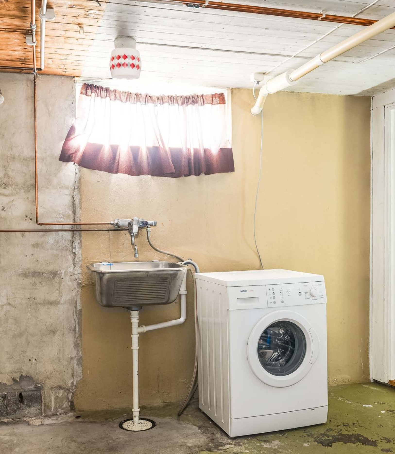
Eldre vaskerom i kjelleren med støpt gulv, sluk, utslagskum og opplegg for vaskemaskin. Vaskerommet har fått TG3 i tilstandsrapport og det anbefales at rommet totalrenoveres.
