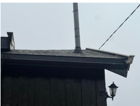
Skjevheter i takkonstruksjon
