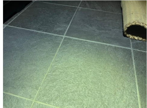
Fliser i vindfang har bom (hullrom)
