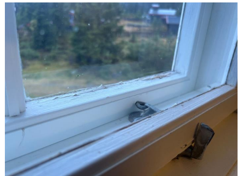
Vedlikeholdsbehov av koblet vindu
