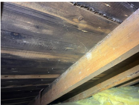
Sortheter og muggsopp på undertak og topp sperrer
