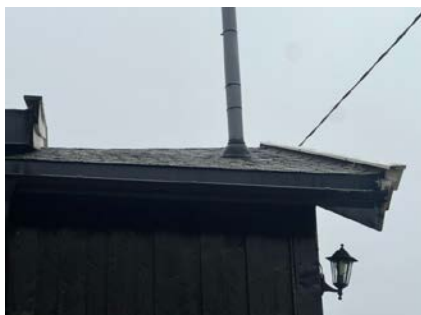
Skjevheter i takkonstruksjon
