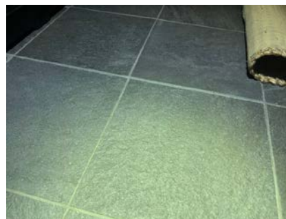
Fliser i vindfang har bom (hullrom)
