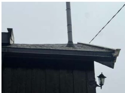
Sig i fundament ved bad er årsak til skjevhet i denne delen av bygning
