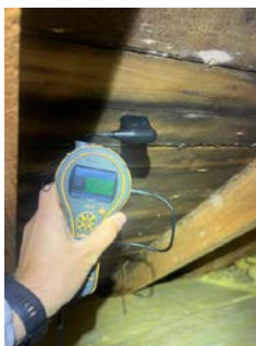
Ved fuktmåletaking var det utslag over normalt fuktinnhold i treverk
