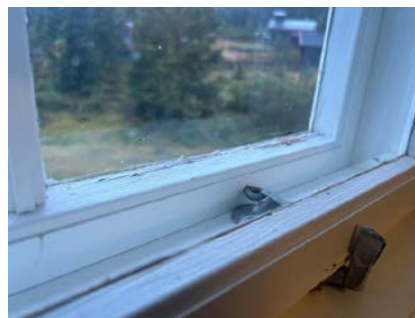
Vedlikeholdsbehov av koblet vindu
