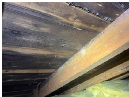
Sorheter og muggsopp på undertak og topp sperrer
