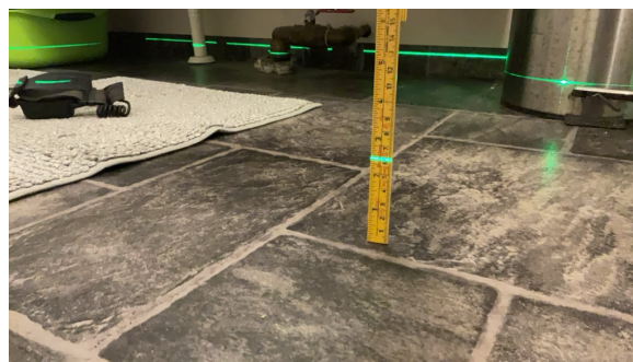
Motfall på deler av gulvet.
