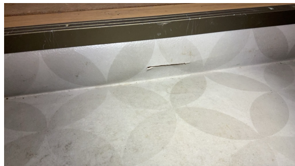
Sprekk i belegg/membran.
