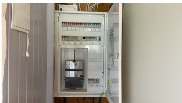
Sikringsskap plassert på toalettrom.
