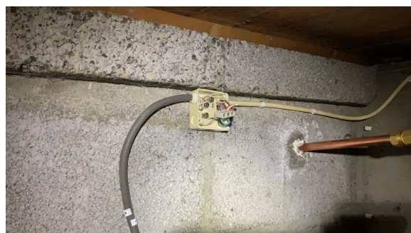
Manglende deksel på koblingsboks.
