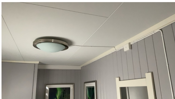
Nedsenk på himlingsplater på toalettrom.
