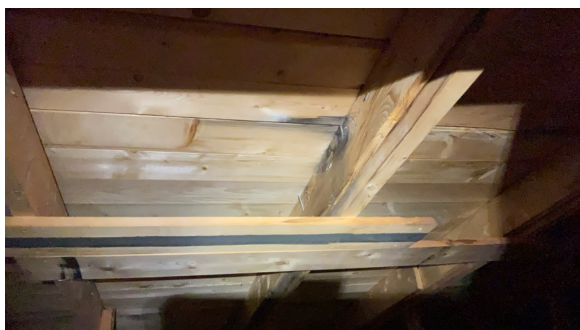
Fuktmerker på undertak.
