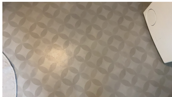
Misfarging på belegg.
