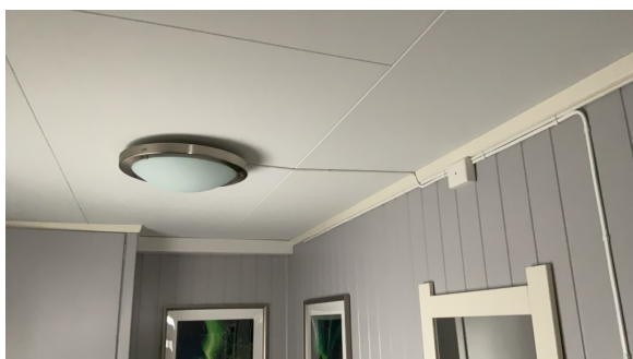
Nedsenk på himlingsplater på toalettrom.
