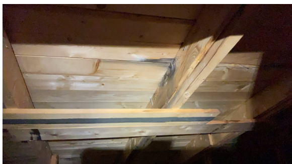
Fuktmerker på undertak.
