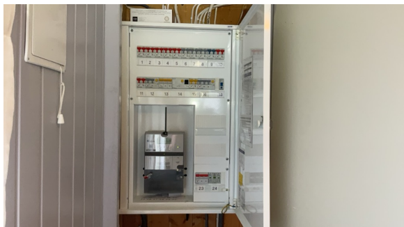
Sikringsskap plassert på toalettrom.
