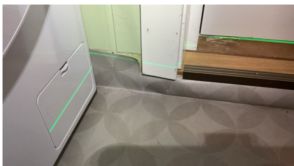
Belegg løsner fra vegg.
