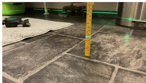
Motfall på deler av gulvet.
