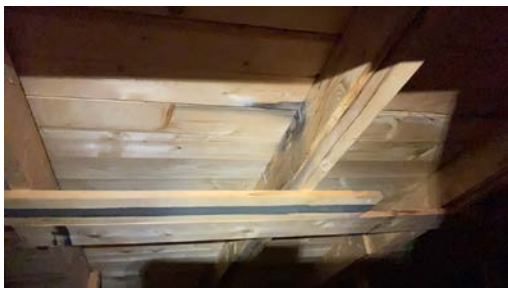
Fuktmerker på undertak.
