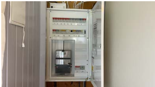
Sikringsskap plassert på toalettrom.
