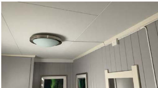
Nedsenk på himlingsplater på toalettrom.
