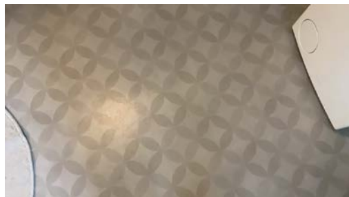
Misfarging på belegg.
