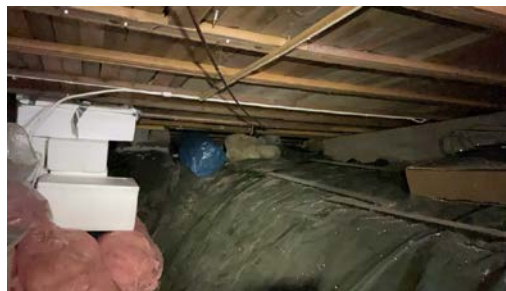
Lav høyde mellom grunnen og etasjeskiller øker risikoen for skader.
