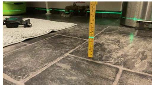
Motfall på deler av gulvet.
