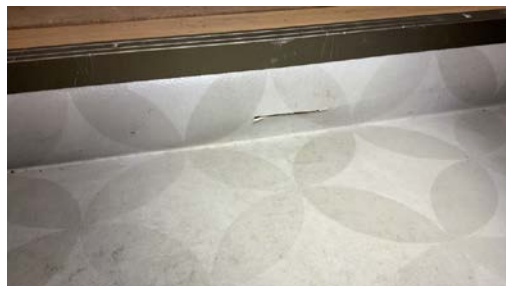
Sprekk i belegg/membran.
