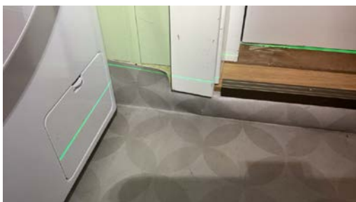
Belegg løsner fra vegg.
