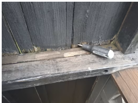
Råteskader i levegg.
