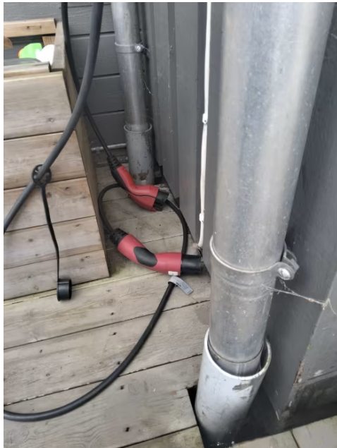
Taknedløp er ført ned i lukkede rør.
