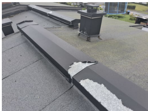
Plastbelegg på beslag flasser av.
