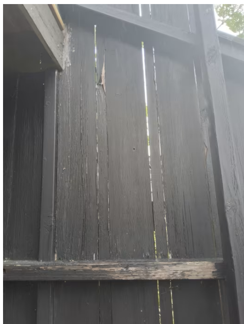
Levegg er værslitt.
