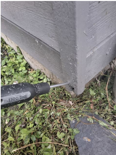
Det registreres noe råteskader på kledningen.
