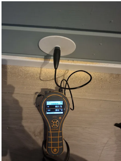
Bilde fra fuktmåling i veggkonstruksjon tilstøtende våtsone.
