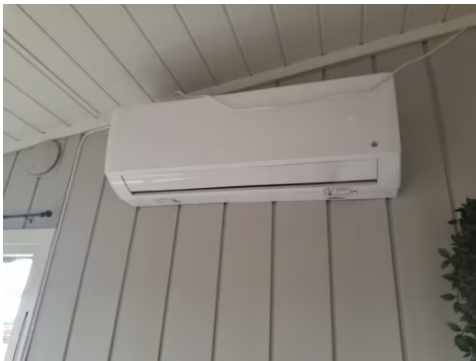
Varmepumpe montert i stue.
