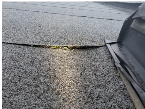
Det registreres mosevekst i skjøt på takpapp.
