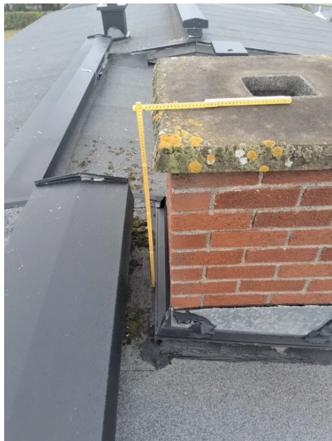
Pipebeslag har avflasket plastbelegg.
