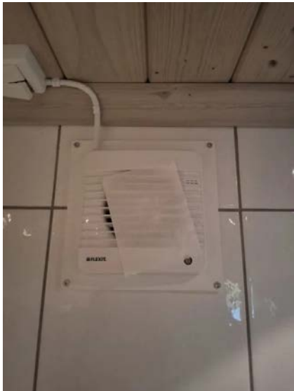
Avtrekkseffekten er testet med papir.
