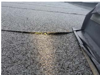
Det registreres mosevekst i skjøt på takpapp.
