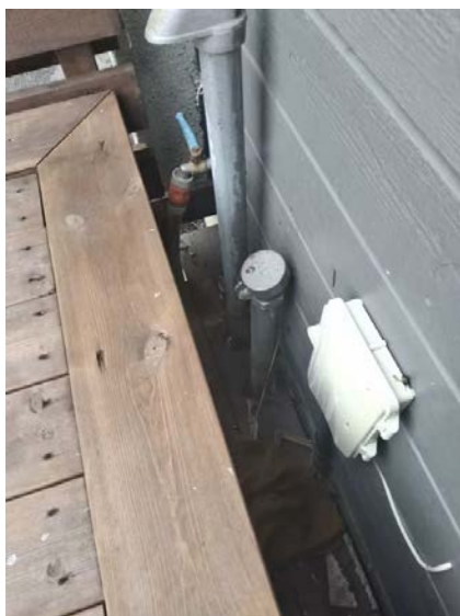
Påfyllingsrør til nedgravd oljetank.
