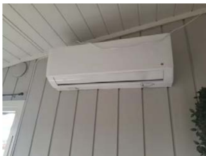
Varmepumpe montert i stue.
