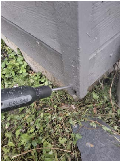
Det registreres noe råteskader på kledningen.
