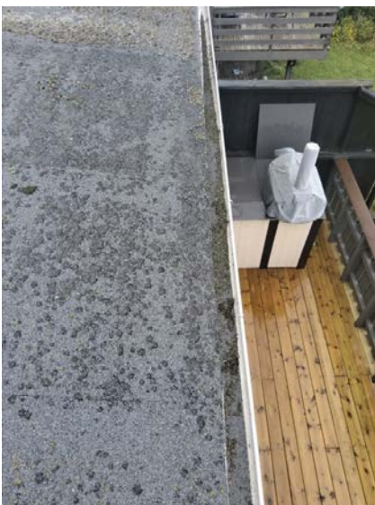
Takrenner er stedvis halvfulle med shingel.
