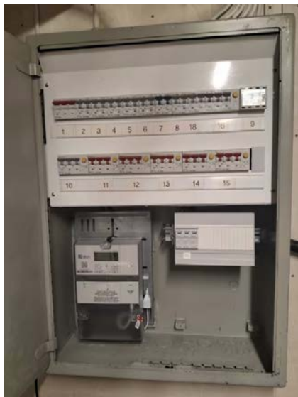
Sikringsskap med automatsikringer plassert i bod.
