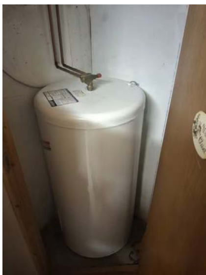
Varmtvannsbereder er plassert i bod i underetasje.
