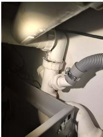
Det registreres en drypplekkasje fra avløpsrør på kjøkken.
