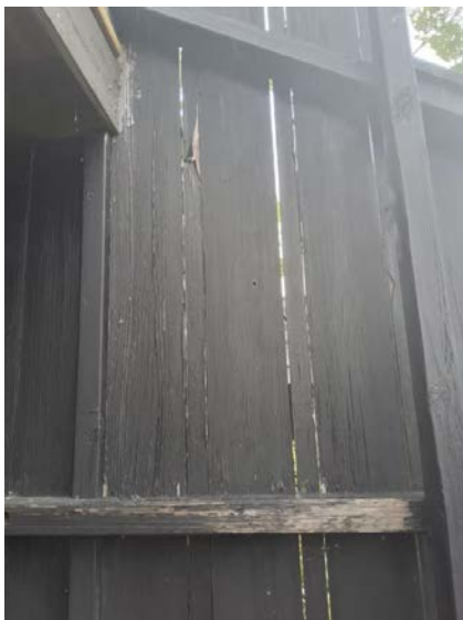
Levegg er værslitt.
