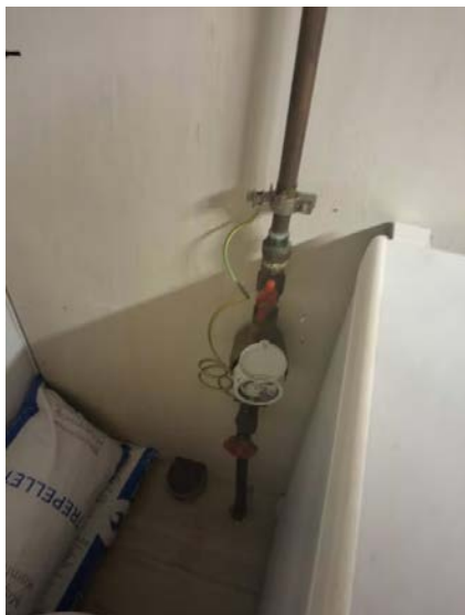
Hovedstoppekran er plassert i bod i underetasje.
