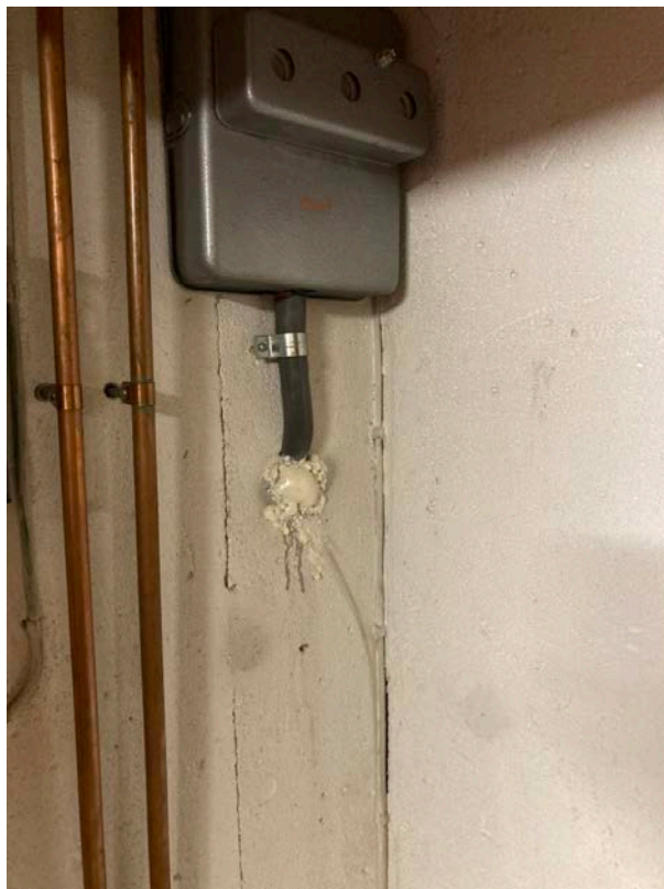
Hull tettet. Ok
