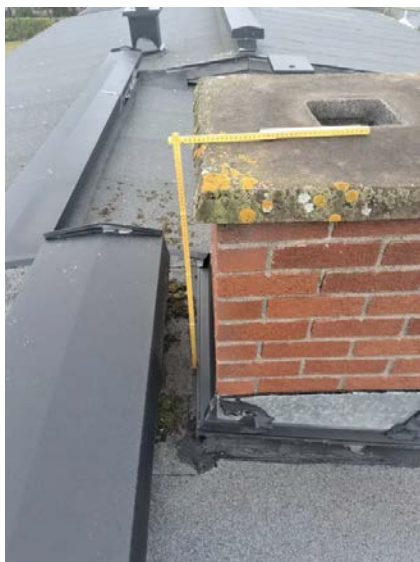
Pipebeslag har avflasset plastbelegg.
