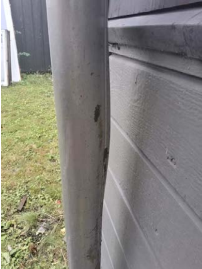
Det registreres bulker på nedløpsrør.
