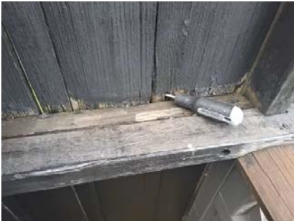
Råteskader i levegg.
