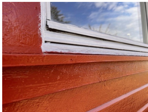
Slitasje på vinduer.
