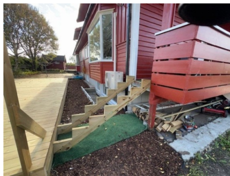
Trapp mangler rekkverk og trinn.
