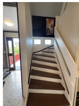
Trapp mangler håndløper på vegg.
