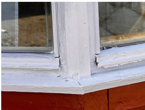
Råteskder i karnapp vinduer.
