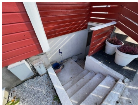
Rekkeverk mangler på kjellertrapp.
