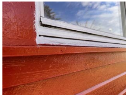
Slitasje på vinduer.
