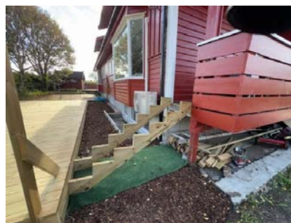
Trapp mangler rekkverk og trinn.
