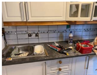
Kjøkken uten avtrekk
