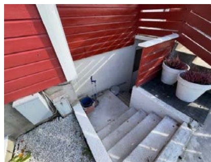
Rekkverk mangler på kjellertrapp.
