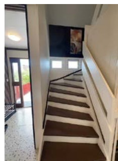
Trapp mangler håndløper på vegg.
