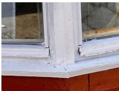
Råteskder i karm på vinduer.
