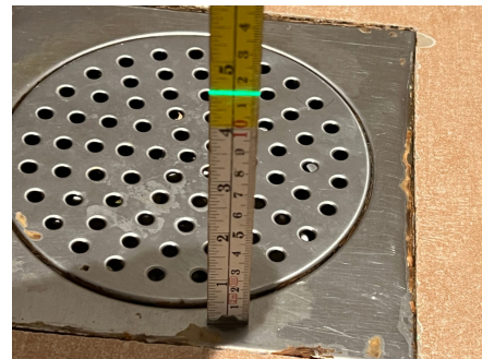
Fallforhold ca. 115 mm topp slukrist i dusjsone
