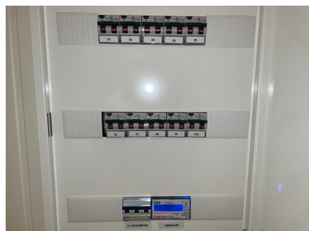
Sikringskap til hybel 2
