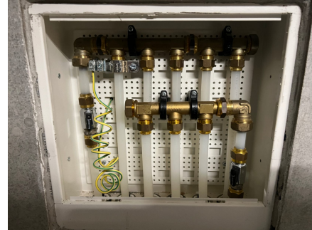
Vannfordelerskap i 2.etg
