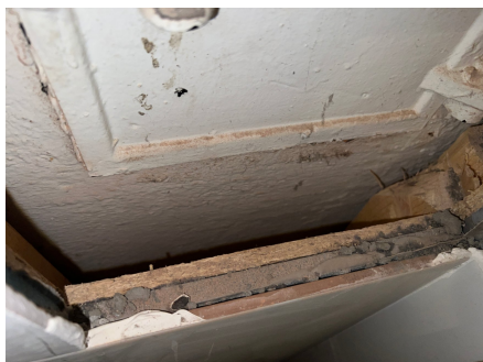
Sotluke og baderomsvegg i kjeller
