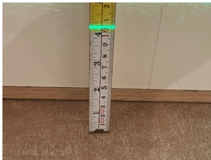
Fallforhold ca. 105 mm overkant gulv ved terskel
