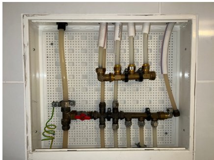
Vannfordelerskap i kjeller - hybel 1
