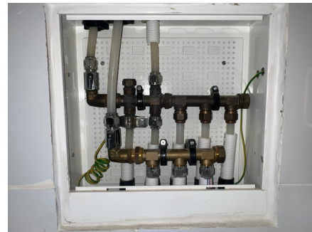
Vannfordelerskap i kjeller - hybel 2
