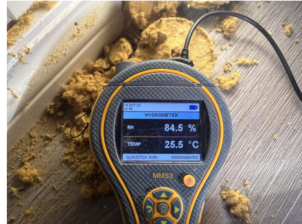
Hulltaking i tilstøtende soverom - fuktsøk med måleprobe
