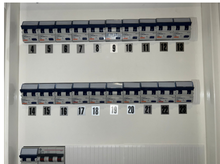
Sikringskap i 1.etg
