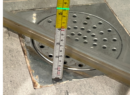
Fallforhold ca. 130 mm topp slukrist i dusjsone
