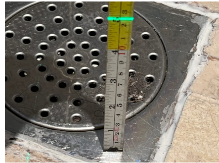
Fallforhold ca. 125 mm topp slukrist i dusjsone
