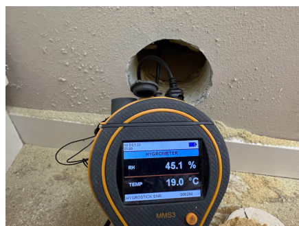
Hulltaking i tilstøtende soverom - fuktsøk med måleprobe
