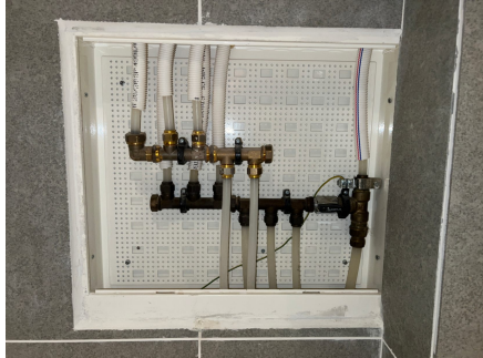
Vannfordelerskap i 1.etg
