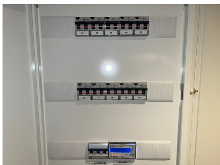
Sikringskap til hybel 1
