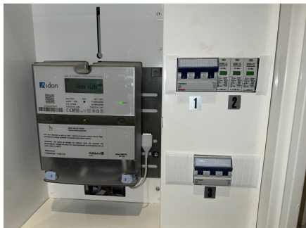
Sikringskap i 1.etg
