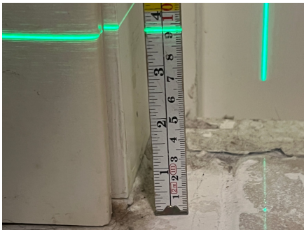
Fallforhold ca. 921 mm overkant gulv ved terskel
