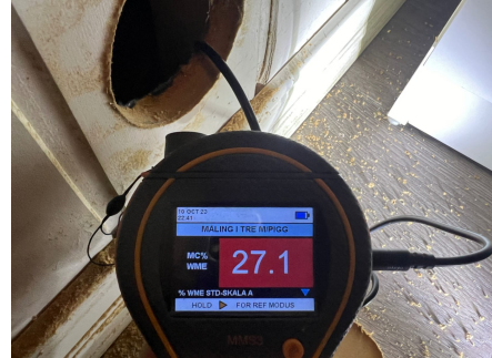
Hulltaking i kjellerbod - fuktutslag
