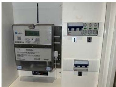
Sikringskapp i 1.etg
