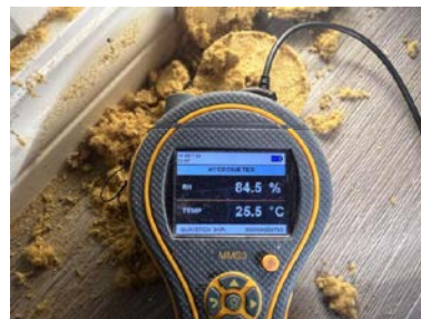
Hulltaking i tilstøtende soverom - fuktsøk med måleprobe
