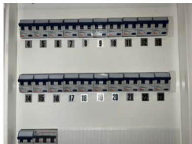
Sikringskapp i 1.etg
