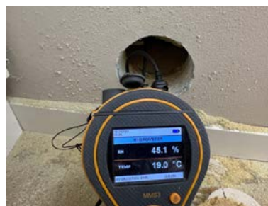
Hulltaking i tilstøtende soverom - fuktsøk med måleprobe
