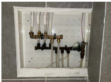
Vannfordelerskap i 1.etg
