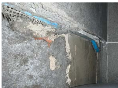
Skade i vegg. Ufagmessig utførelse overflate og membran
