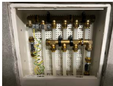
Vannfordelerskap i 2.etg
