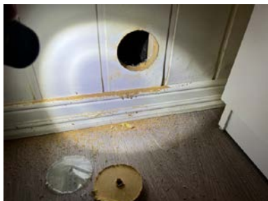
Hulltaking i kjellerbod
