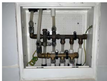
Vannfordelerskap i kjeller - hybel 2
