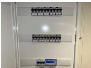
Sikringskapp til hybel 1
