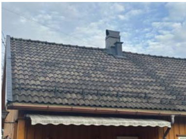
Tekkingen har stedvis falmende farge, slitasje og mosedannelse
