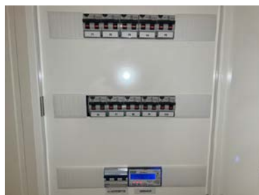
Sikringskapp til hybel 2
