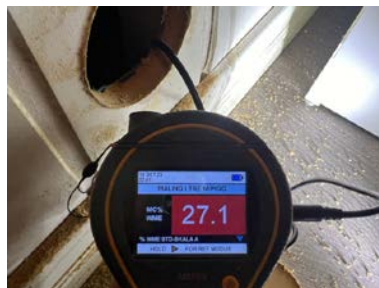
Hulltaking i kjellerbod - fuktutslag
