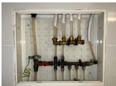
Vannfordelerskap i kjeller - hybel 1
