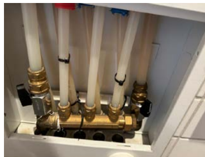
Stoppekraner plassert på bad
