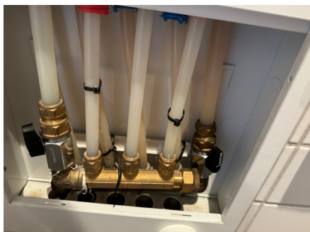
Stoppekraner plassert på bad
