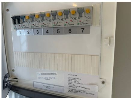
Sikringsskap med automatsikringer.
