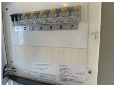
Sikringsskap med automatsikringer.
