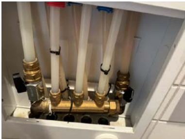
Stoppekraner plassert på bad
