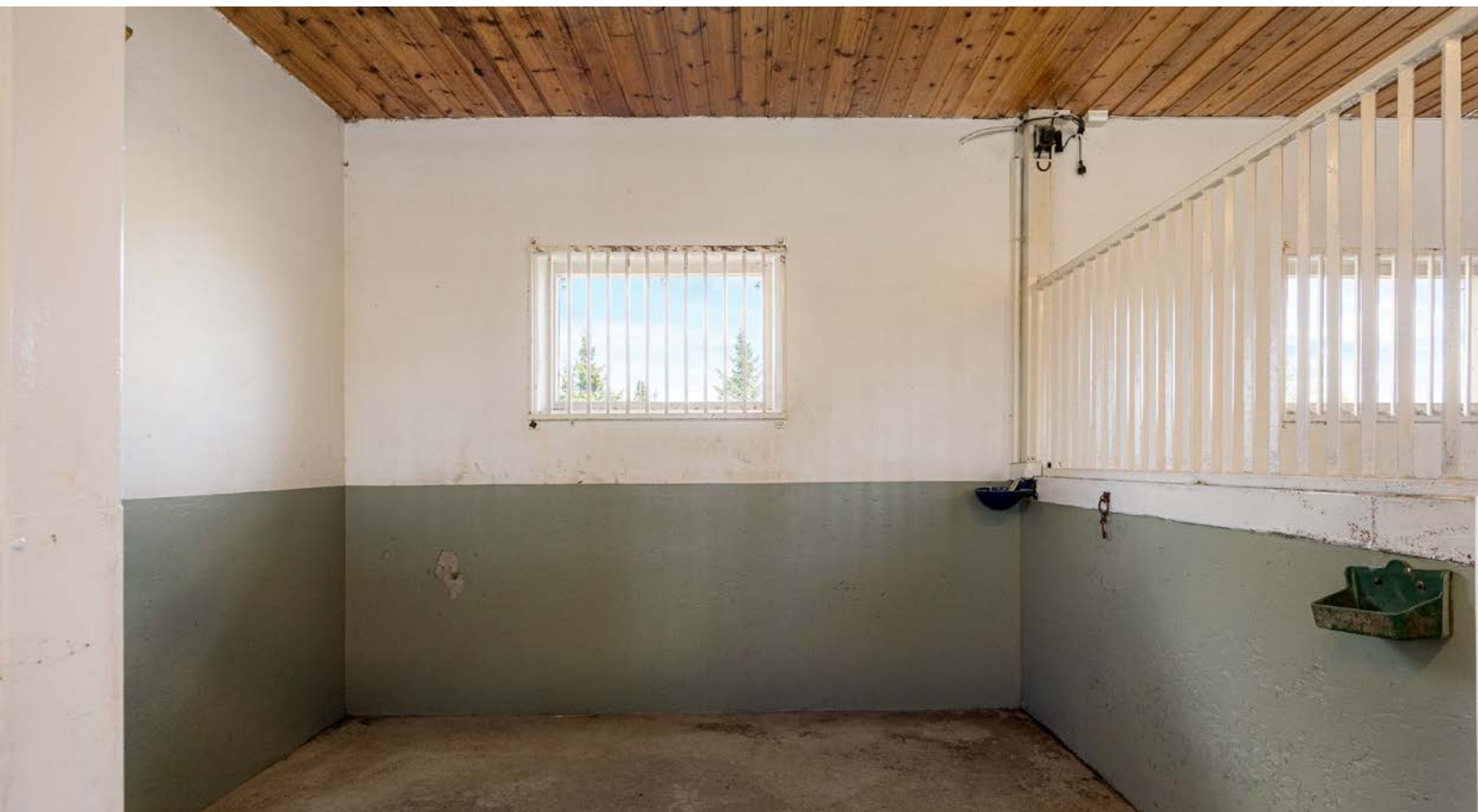
Vaskerommet i stallen er utstyrt med vaskekum og varmtvannsbereder.
