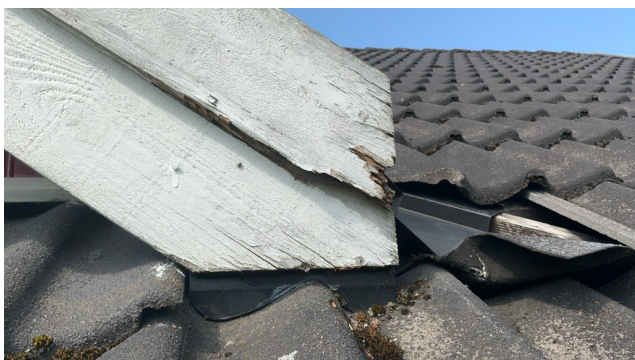
Råte i vindskiver
