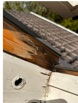
Takvindu slitt. Ingen fuktighet ved måling på befæringsdato
