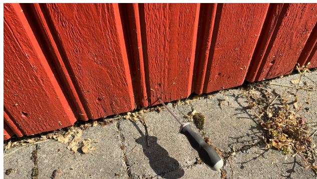
Det er påvist spredte råteskader i bordkledningen.
