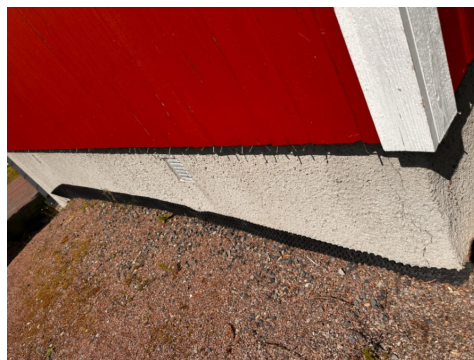
Riss/sprekk i mur
