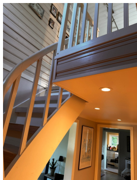
Manglende søyle på dette hjørne
