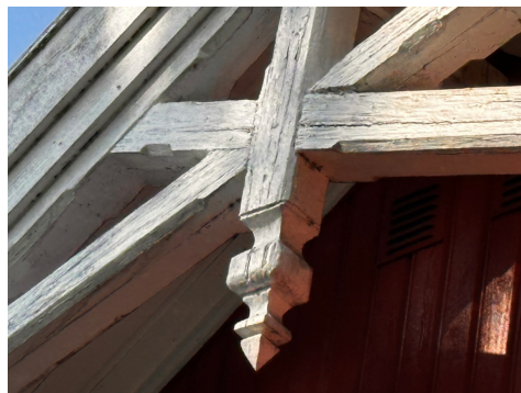
Det er værslitt/oppsprukket trevirke/trepaneler.
