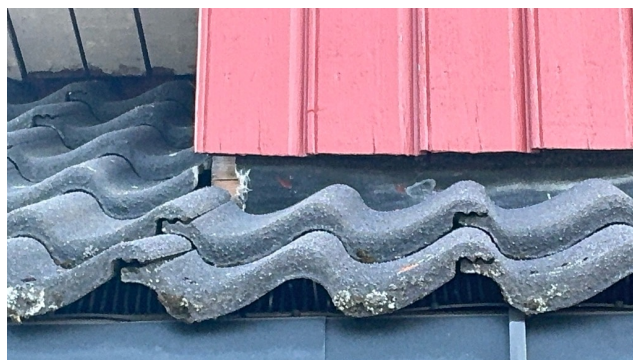
Hull/mangelfull tettelse i overgang vegg tak
