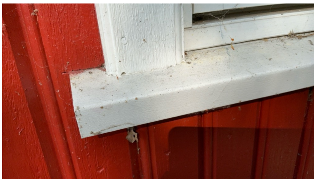
Manglende avstand mellom beslag og treverk
