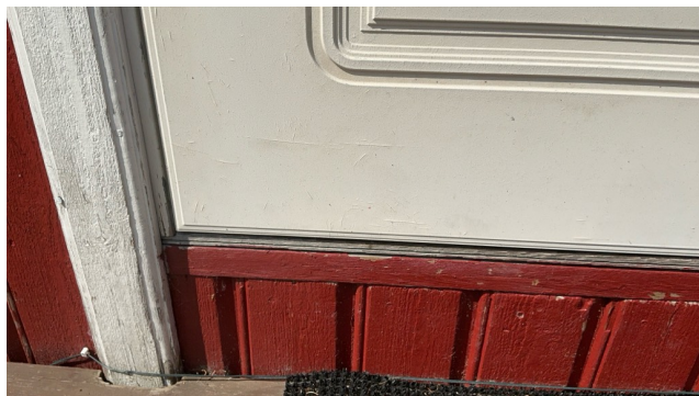
Manglende beslag under dør
