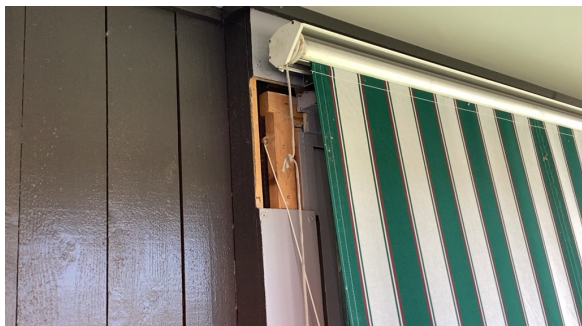
Mangler en fasadeplate.
