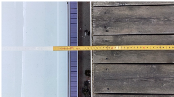
Glippe mellom gulv og rekkverk på mer en 10 cm.
