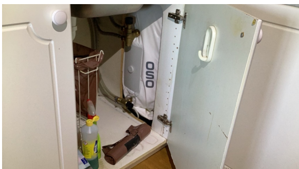
Varmtvannstank i kjøkkenskap.
